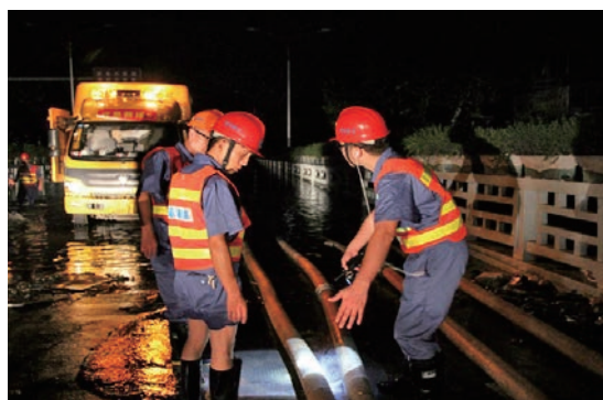
市排水公司雨夜排除道路积水
